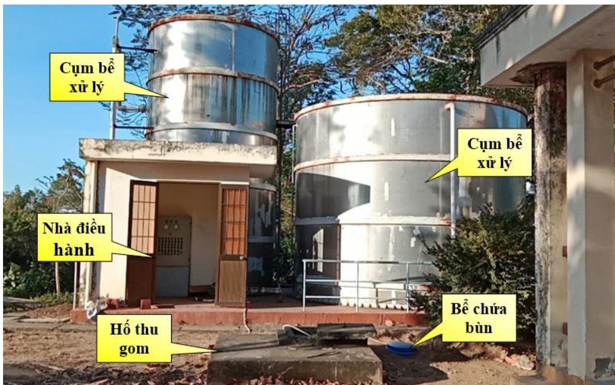
Hình 11. Hệ thống xử lý nước thải, công suất 100 m 3 /ngày đêm
