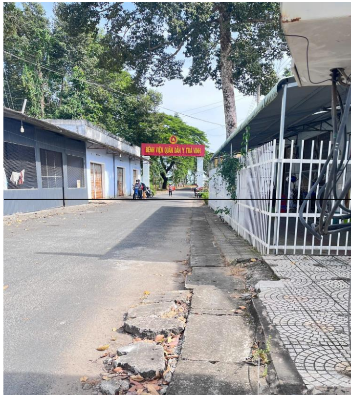
Hình 7. Hệ thống tiêu thoát nước mưa chảy tràn
