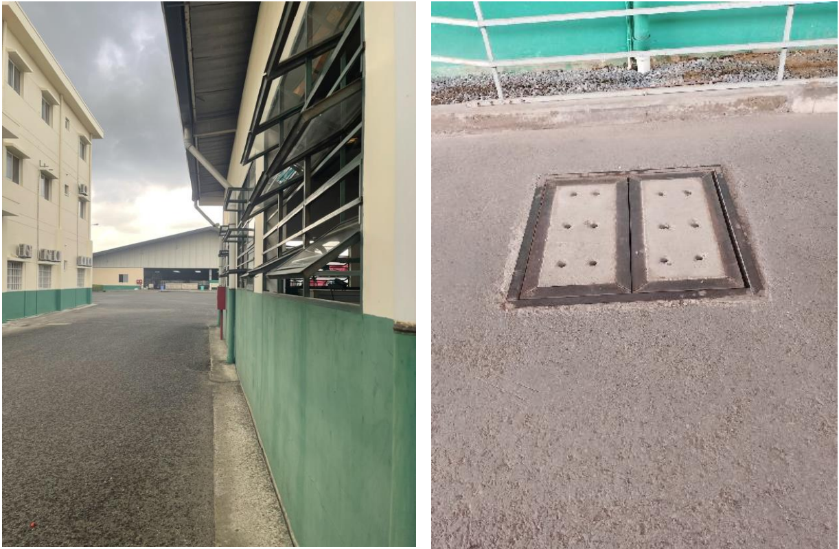
Hình 5. Đường ống và cống thu gom, thoát nước mưa trong khu vực Nhà máy
