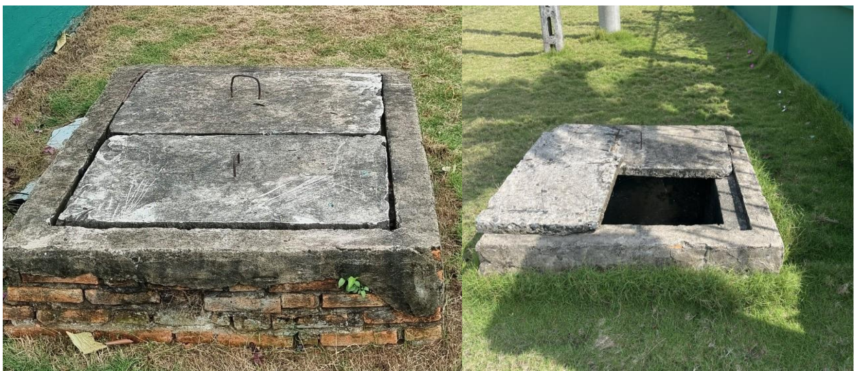
Hình 7. Hồ ga đầu nối nước mưa ra Cống thoát nước mưa Khu công nghiệp Long Đức (tuyến cống dọc trên Đường số 1)
