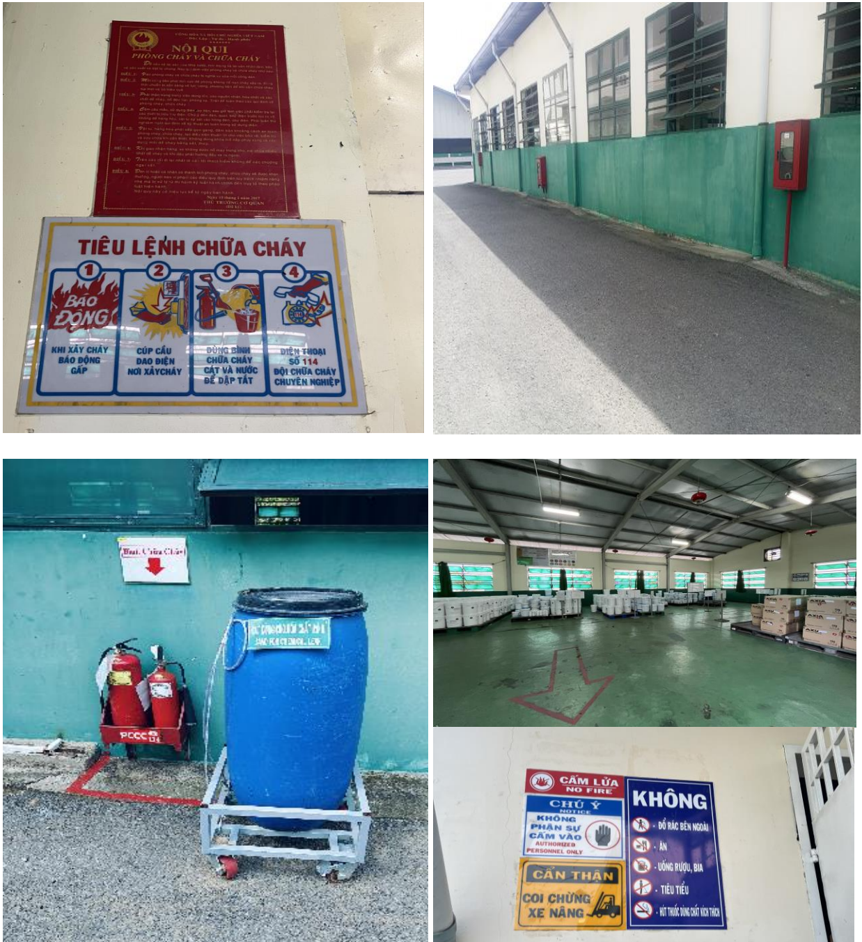
Hình 17. Thiết bị, công trình PCCC tại Nhà máy
