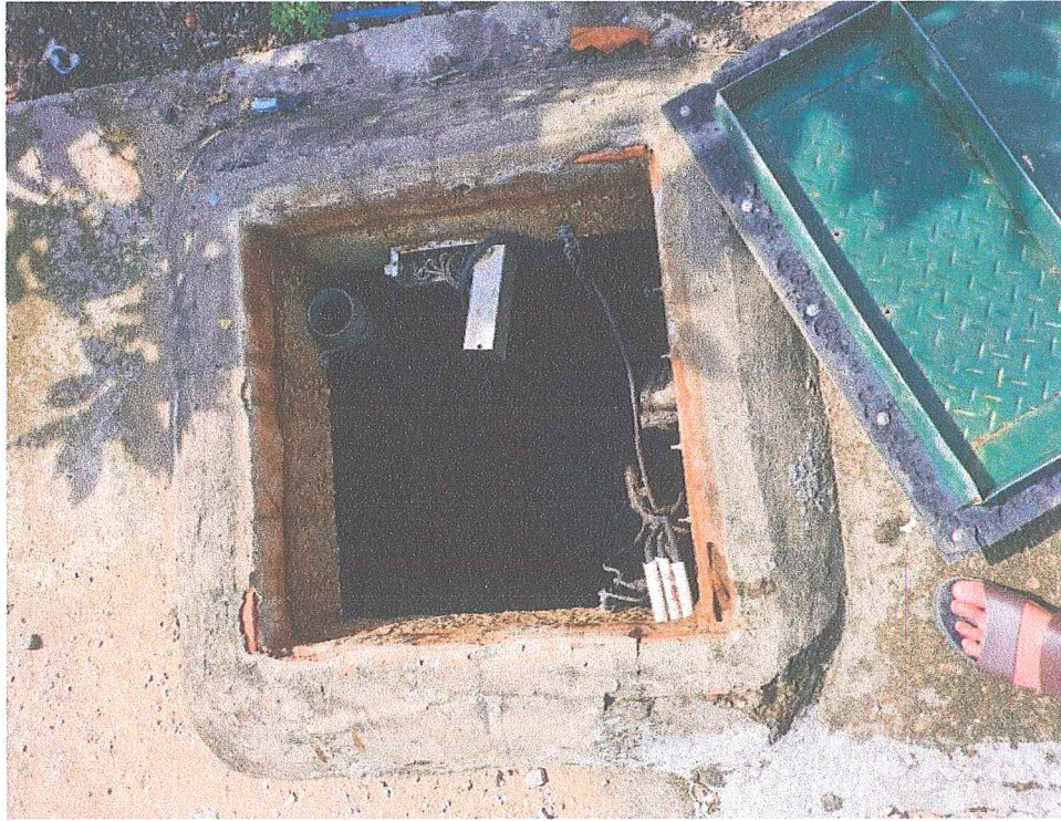
Bể chứa bùn thải
