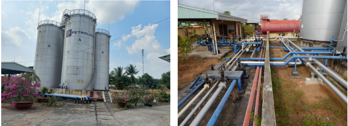
Hình 5. Khu bể chứa và ống công nghệ kho xăng dầu
