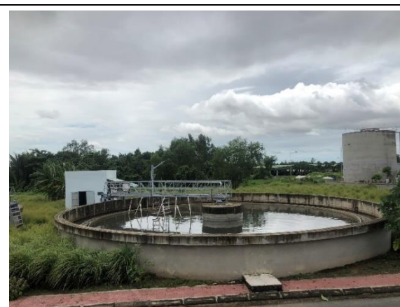
Bể lắng sơ bộ 2
