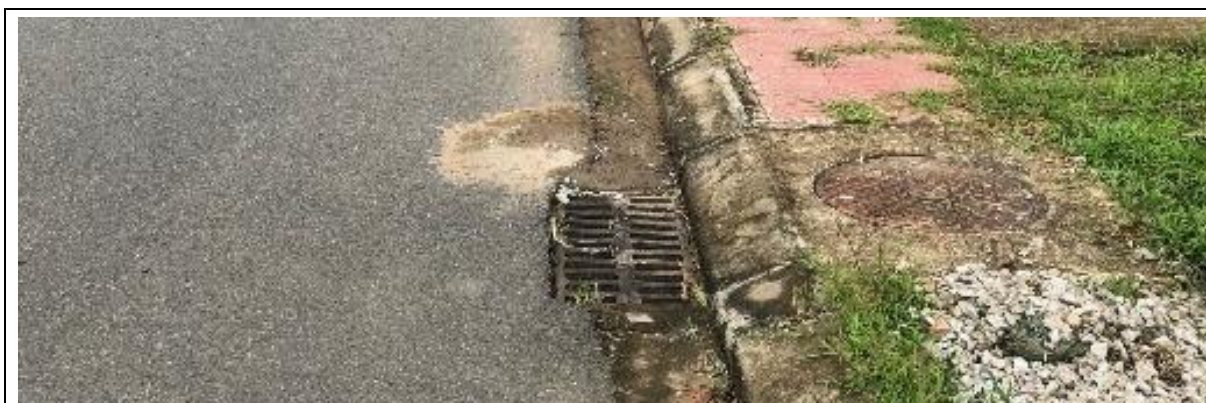
Hệ thống thu gom nước mưa tại nhà máy
