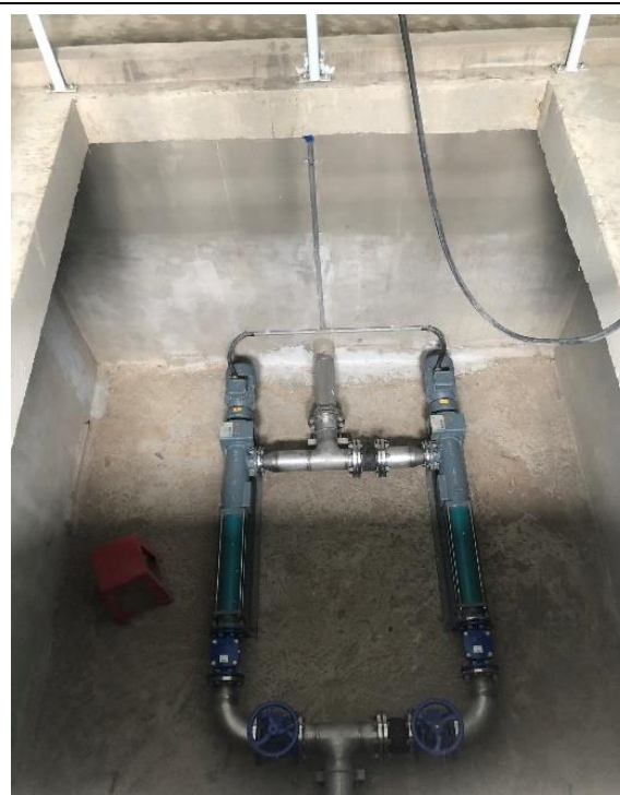
Hệ thống bơm bể nén bùn
