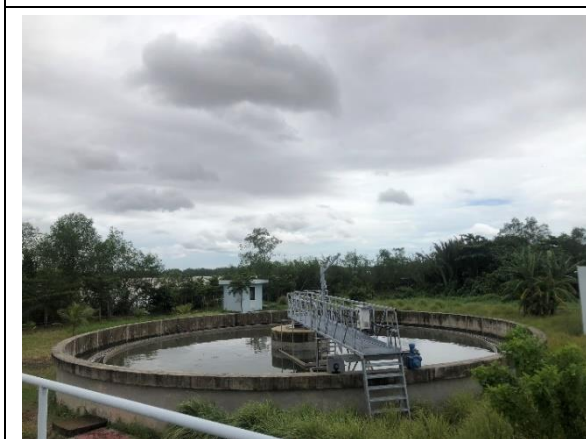
Bể lắng sơ bộ 1
