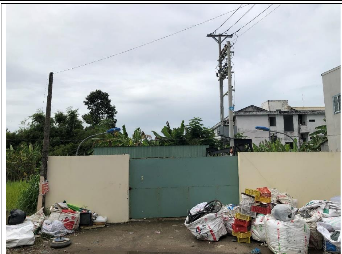
Trạm bơm PS-03
