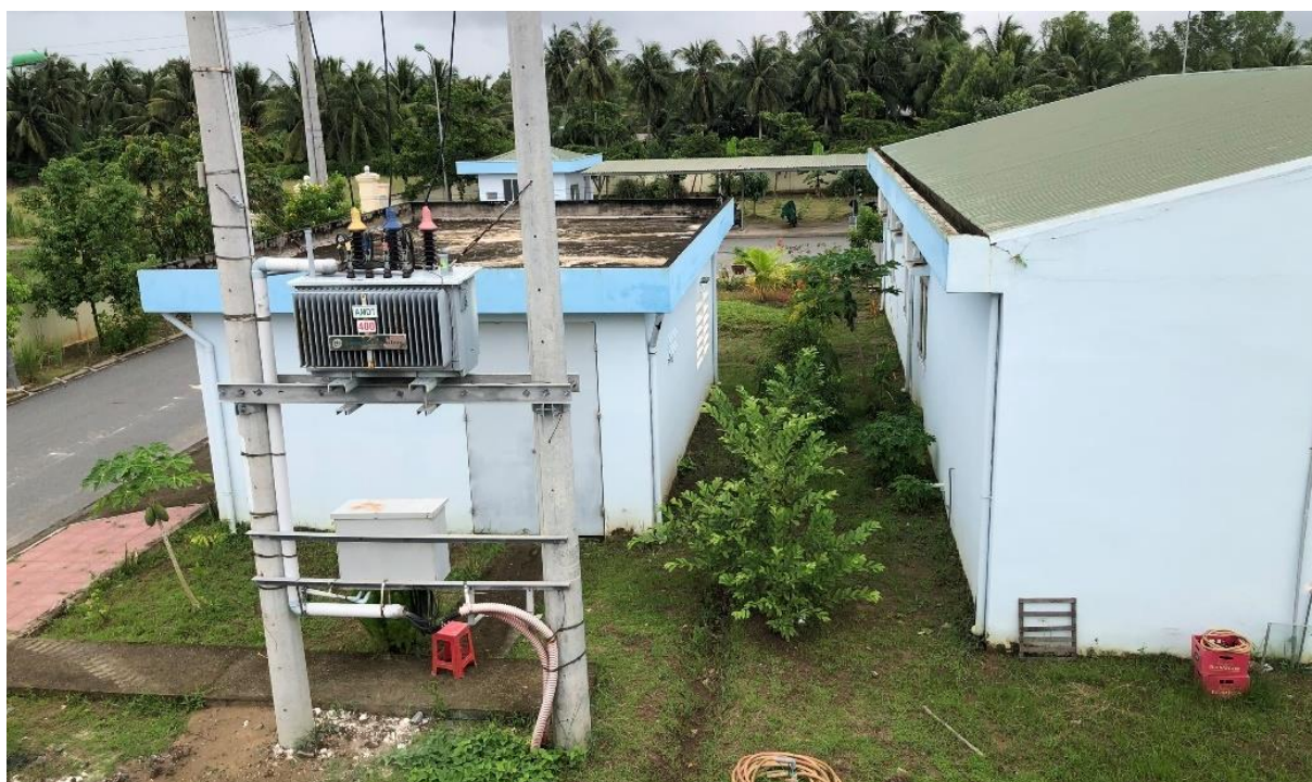
Hình 1.6: Trạm biến thế tại nhà máy xử lý nước thải
