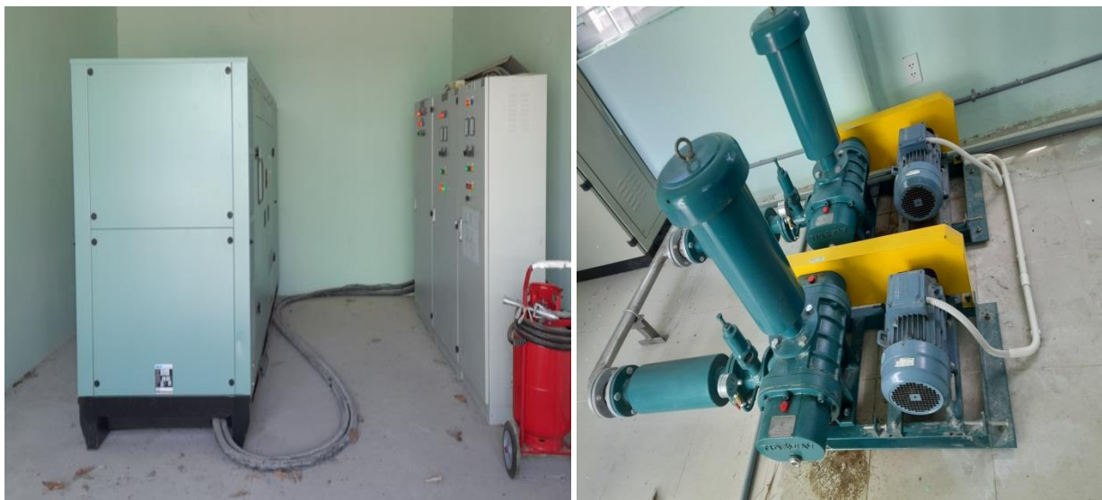
Hình 16: Máy phát điện dự phòng 200KVA và máy bơm sục khí của HTXLNT
