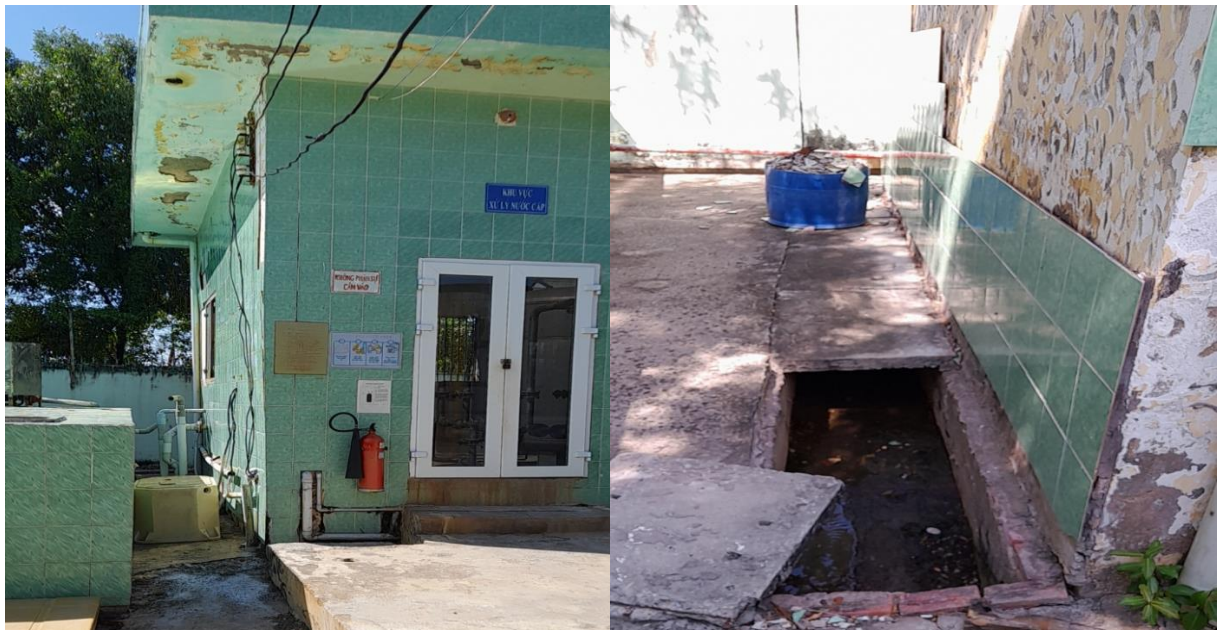
Hình 5. Vị trí hố ga thoát nước mưa chảy tràn
