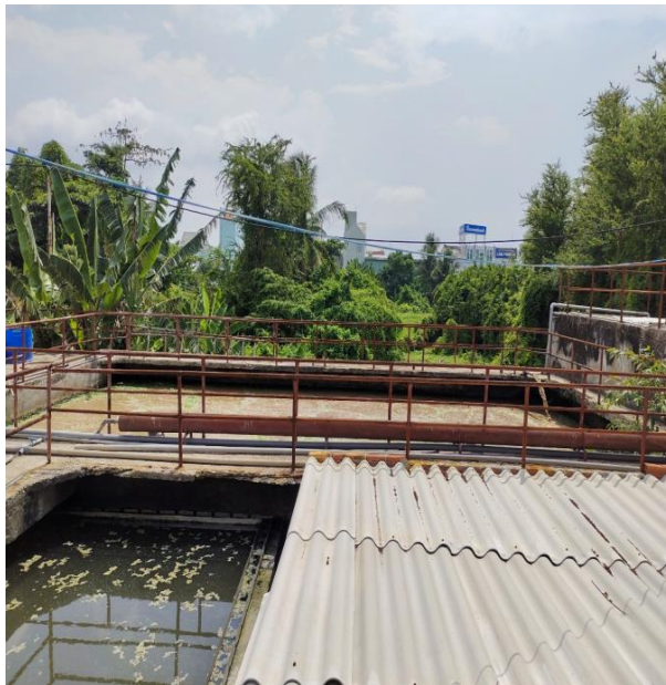
Bể xử lý nước thải
