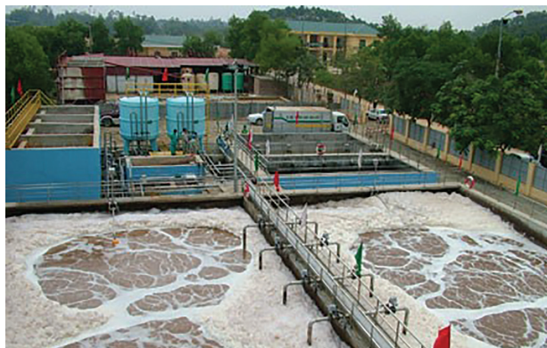
Công trình xử lý nước thải
