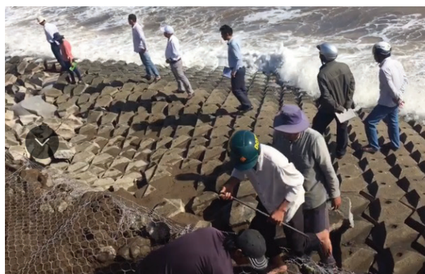
Đoàn công tác của tỉnh khảo sát tình trạng sụt lún công trình kè bảo vệ đoạn xung yếu bờ biển xã Hiệp Thạnh, thị xã Duyên Hải đầu năm 2021
